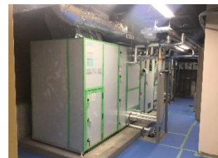
高効率空調設備への更新、ナイトページ制御機器の導入
