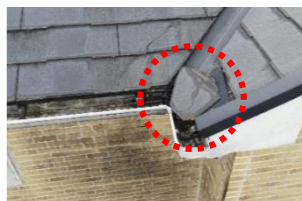
ドローンで発見した屋根の破損
